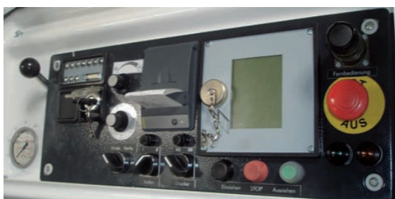
Windensteuerung mit PC 210 und Drucker
